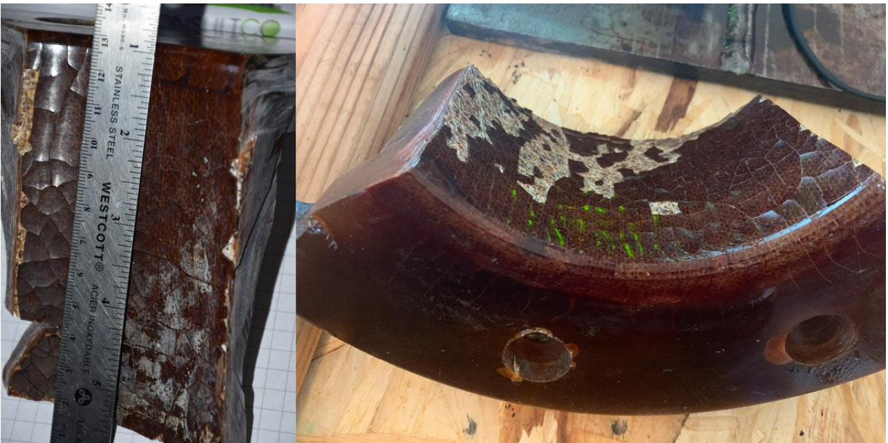
Abbildung 4: Zustand der Innenfläche und Korrosion von GFK
